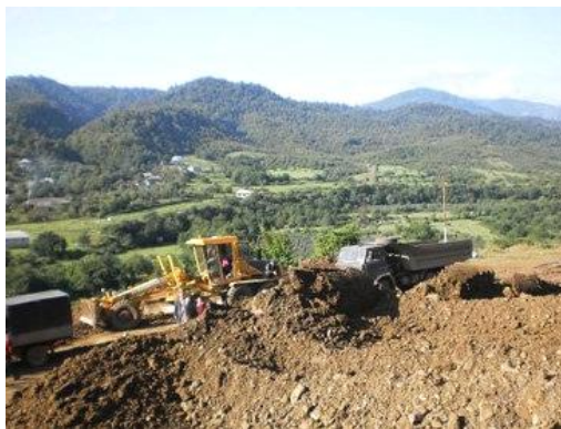
Рис. 3. Оползень на дороге Губа-Гонагкэнд (фото – 26 марта 2013 г.)
